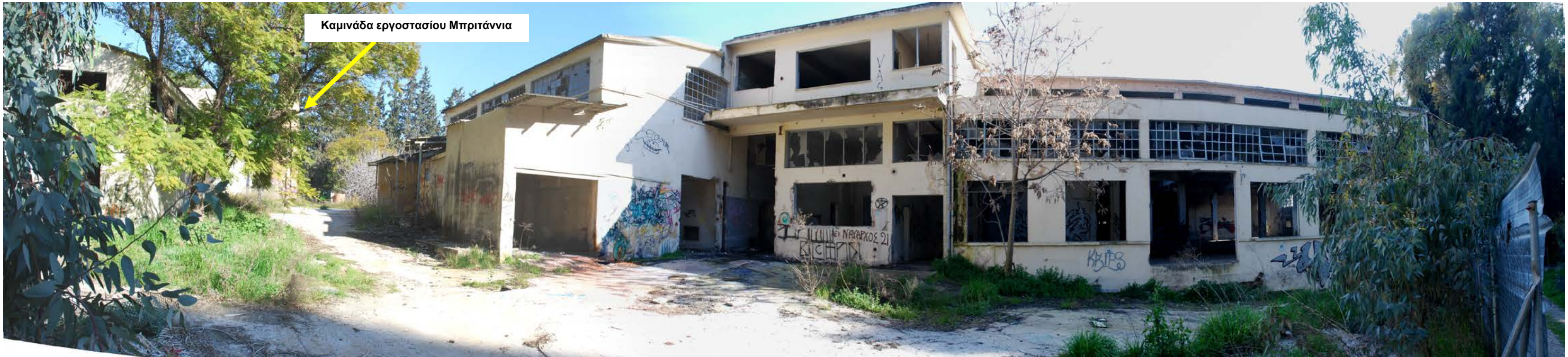
Φωτ. 22 Άποψη του περιβάλλοντος χώρου και των κτιρίων του εργοστασίου Μπιτάννια. Σημειώνεται η θέση της καμινάδας
